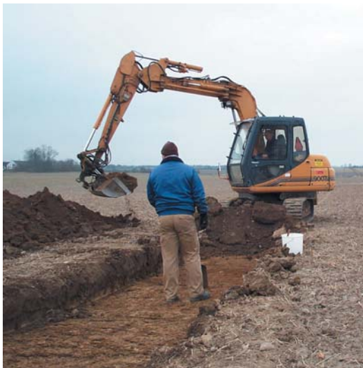
Den maskingravede søgegrøft i vandledningslinien med Jacob Brønd i grøften og Leif Møller i maskinen.
